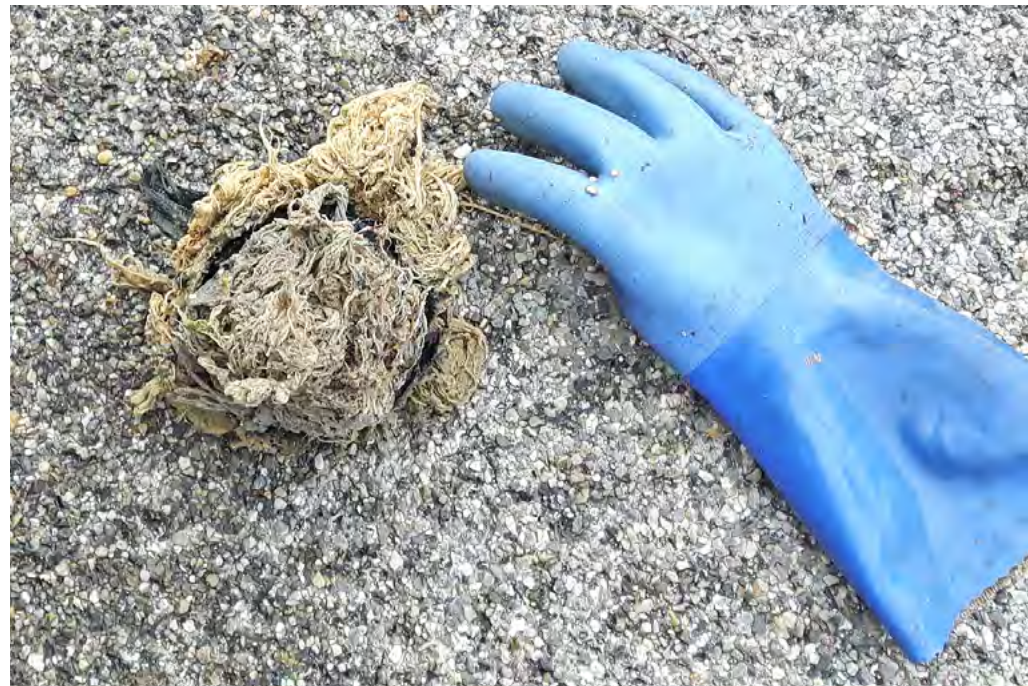
Fotos von Verstopfung aus dem Pumpwerk Hof: Putzfäden und Swiffer-Tücher.
